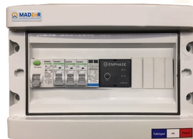
Coffret de protection AC avec Q Relay
